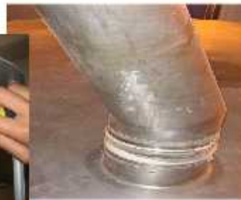
Problemas de acumulación de residuos
